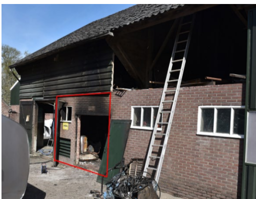
Afbeelding 2: Voorzijde van de technische ruimte (rood omrand)
