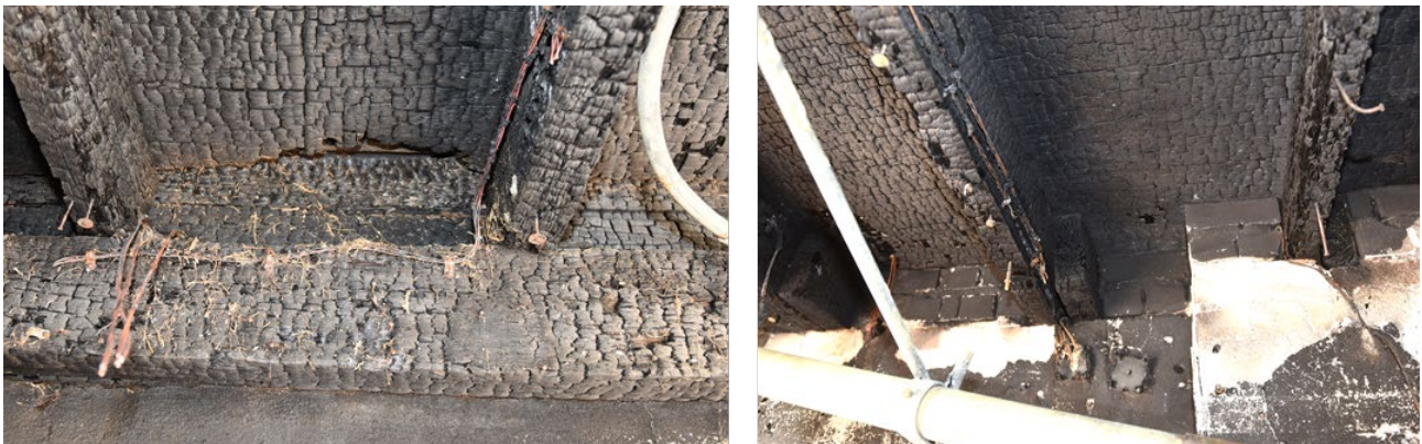
Afbeelding 12: Plafondconstructie technische ruimte. De isolatieplaten zijn volledig weggebrand.
