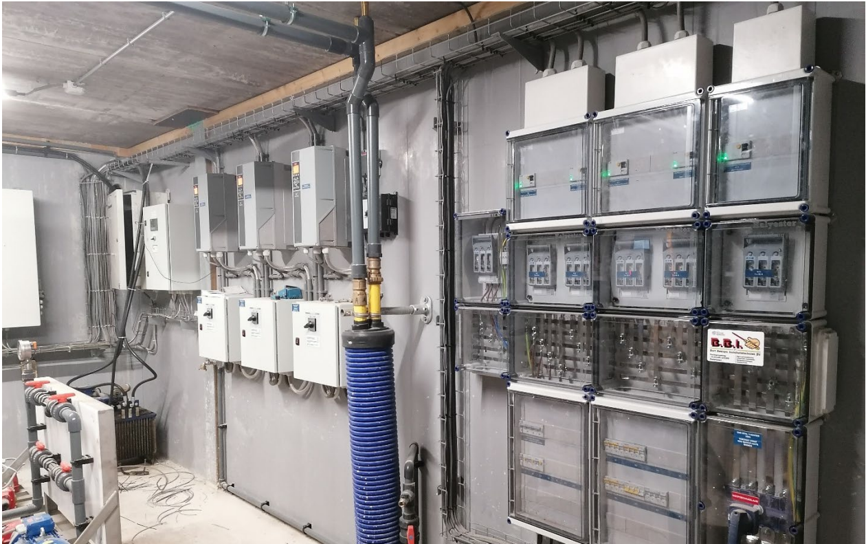
Figuur 5.2 Een voorbeeld van een technische ruimte zoals deze is uitgevoerd bij nieuwbouw.
